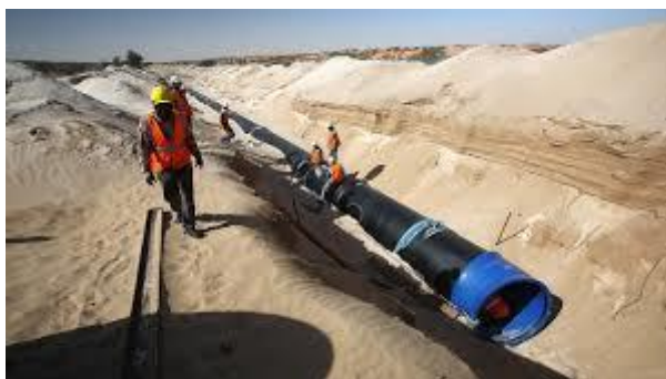
Photo 2. 21: Vulnérabilité de la tuyauterie du canal de L'Aftout alimentant la capitale NKTT, du fait de son installation dans un sol aux variabilités côtières.
