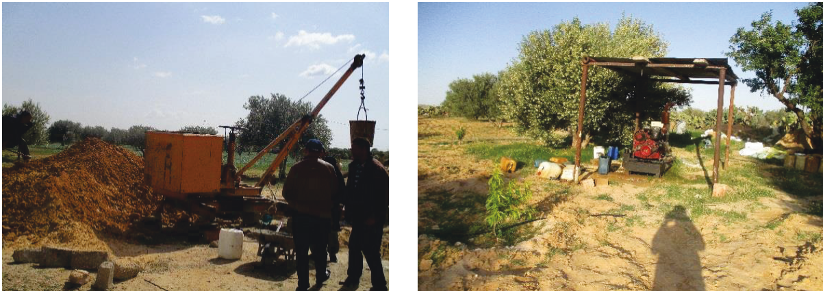
Figure 1-10 : Le mouvement d’approfondissement et de creusement des forages privés qui fonctionnent en majorité par le gasoil
