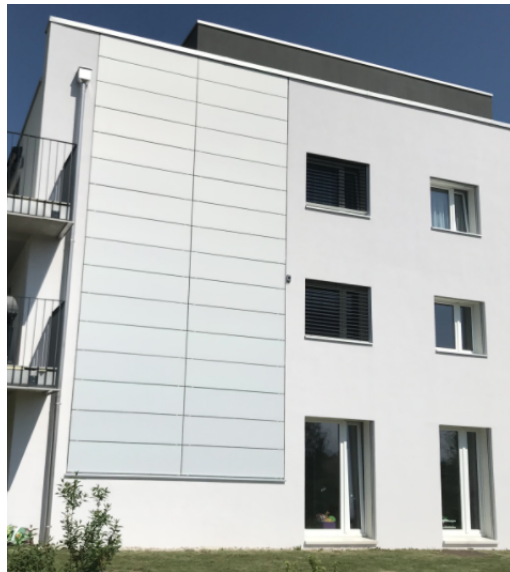
FIGURE 1.10 – Façade utilisant la technologie Solaxess en Suisse [14]
