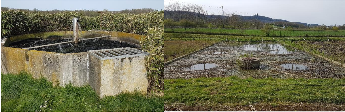
Figure II.8 : Photos du lit bactérien (à gauche) et du premier étage de filtration de la STEU de Vercia en hiver après la coupe des roseaux (à droite).
