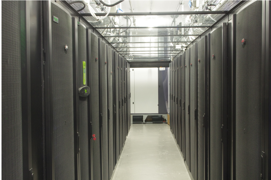
FIGURE 5.67 – Salle serveur hébergeant les machines du Pôle de Modélisation et de Calcul en Sciences de l’Ingénieur et de l’Informatique (PMCS2I)
