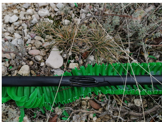
(a) Trou dans la protection mécanique du câble.
