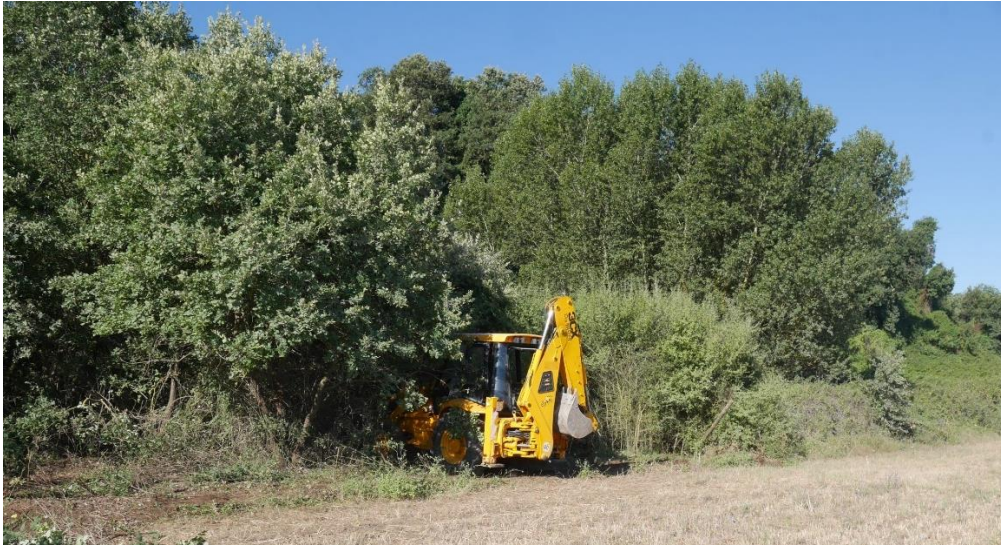
Figure 28 : début des opérations de nettoyage au sanctuaire (juillet 2020). Arbres et ronces sont partout. Cl. E. Lovergne
