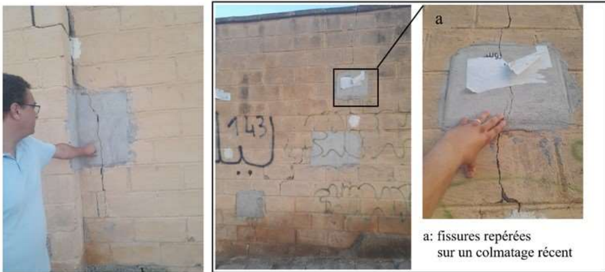
Figure 19 : Fissures dans les murs de clôture en maçonnerie.
