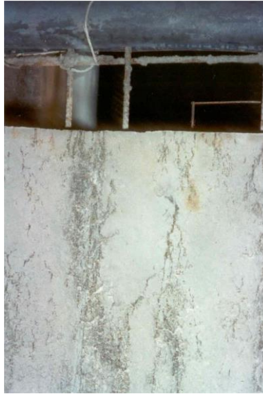
Figure 1-35 : Parement d'une pièce de béton armé ayant présenté une localisation du ressuage [13]
