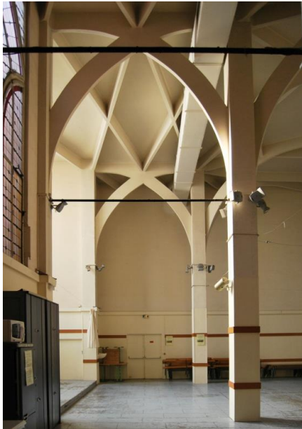
205 Les réseaux modernes dans le monument historique. Église basse : gaine d'air, éclairage. Photo: l'auteur, 2012.
