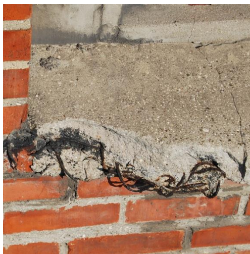
207 Appui de baie en ciment armé. Armatures dénudées mises en peintures antirouille. Photo : l'auteur, 2016.
