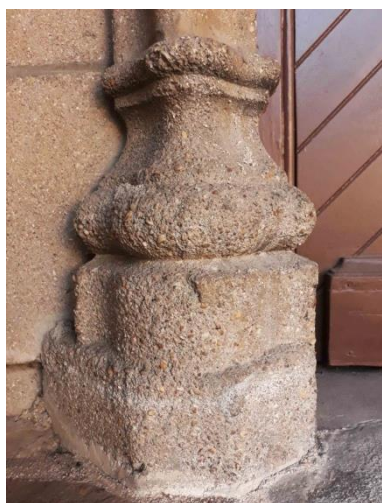
194 Érosion légère du béton. Notre-Dame-de-l'Assomption, Rungis. Photo : l'auteur, 2017.
