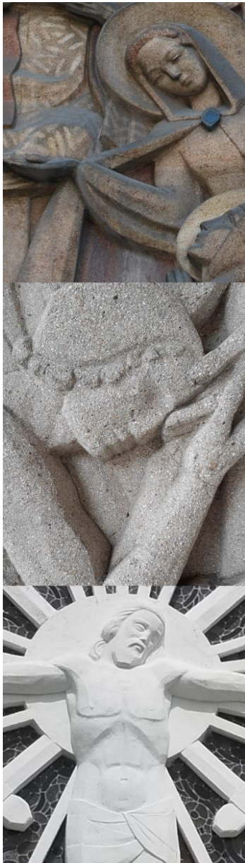
198 Exposition aux intempéries et vieillissement des reliefs en béton. Du haut vers le bas : exposé sur portail (Sainte-Odile, Paris), protégé sous porche (Saint-Vaast, Moreuil), exposé sur rosace mais peint (Saint-Rémi, Roupy). Photo : l'auteur, 2023.
