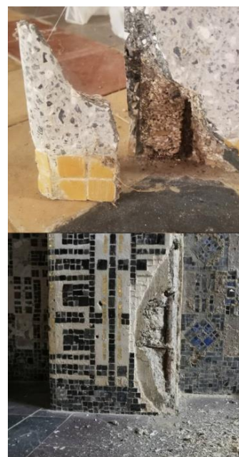
227 Corrosion et mosaïques. En haut : Saint-Martin, Martigny-Courpierre. En bas : Saint-Julien, Domfront. Photo : l'auteur (haut), Lympia (bas).
