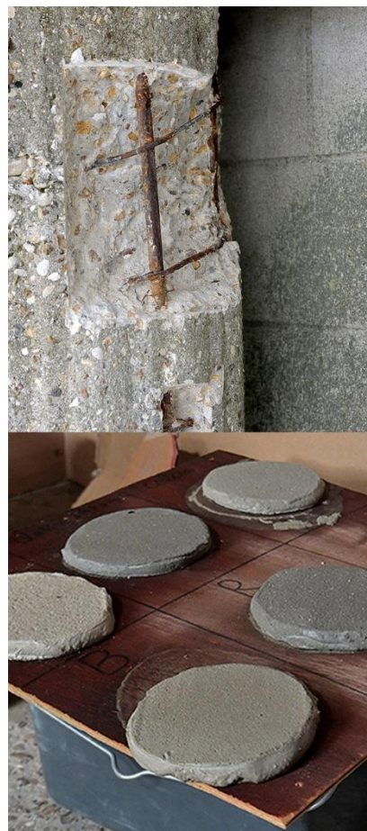
215 Chantier de restauration 2022-2023. Purge des fers sur une colonne du clocher. Échantillons de teinte. Photo : Chantiers du Cardinal, GF, 2022.
