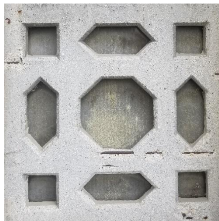
229 Armatures dénudées sur un remplage en béton armé. Saint-Martin, Martigny-Courpierre. Photo : l'auteur, 2023.
