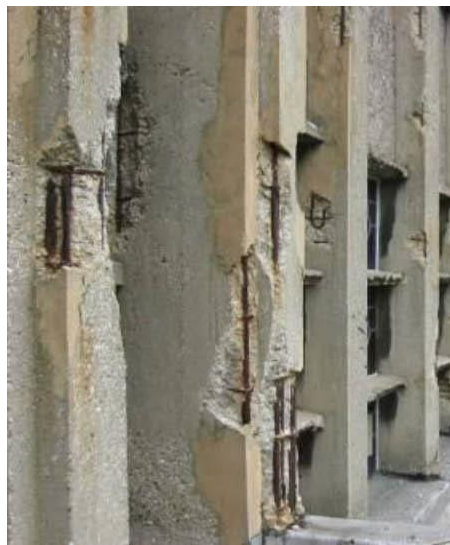
219 Reconstitutions palliatives inefficaces. Vue de la façade sud avant les travaux de restauration. Photo : P.-A. Gatier.
