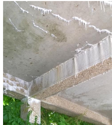
191 Cristallisation de carbonates (calcite) en sous-face de dalles et poutres en béton armé. Notre-Dame-de-la-Trinité, Blois (cloître). Photo : l'auteur, 2015.
