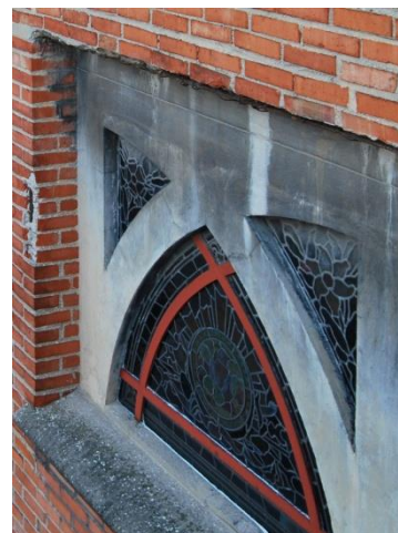
189 Noircissement du ciment armé dans une zone non soumise à la pluie. Saint-Jean de Montmartre. Baie sud-est. Photo : l'auteur, 2012.
