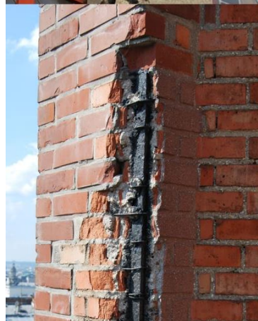
204 Désordres et réparations inadaptées. En haut : remplage d'origine doublé de béton armé dans les années 1930. En bas : pilier d'angle extérieur avec des traces de réparations successives (briques neuves et fausses briques en mortier). Photo : l'auteur, 2016.
