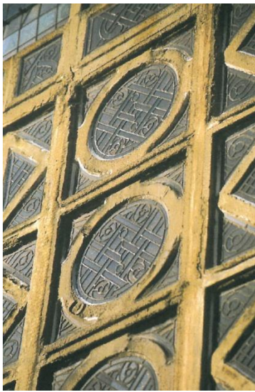
212 Claustras d'origine dégradés. Début des années 1990. Patrimoine restauré , N° 2, 1996. DRAC IDF.
