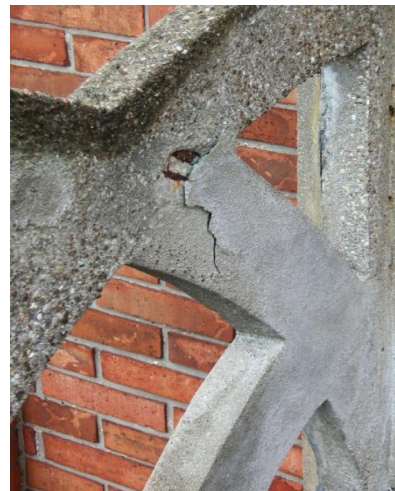
196 Reconstitution ponctuelle incompatible avec le ciment armé d'origine. Saint-Jean de Montmartre. Garde-corps. Photo : L. Fouqueray, BECH, 2007.
