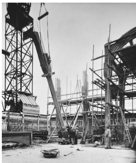
136 Notre-Dame-de-la-Trinité, Blois. Chantier de construction du projet de Ch.-H. Besnard. Montage d'un pilier en ciment armé préfabriqué. CAAC. BESCH-G-30-393. IFA 54/8.
