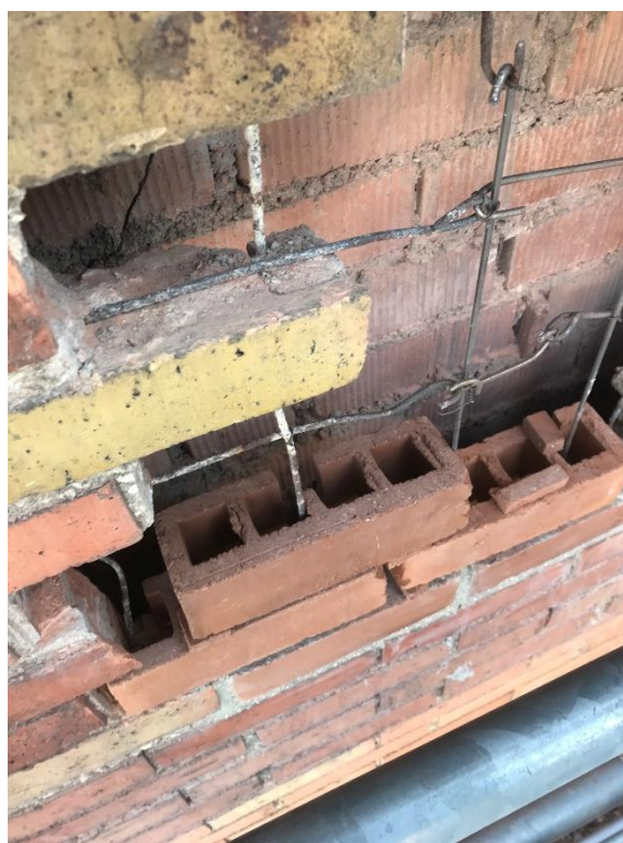
209 Restauration des murs en brique armée. Après la purge, les nouvelles briques creuses doivent être découpées afin de s'insérer dans le réseau d'armatures. Photo : 1090 architectes.
