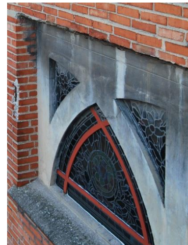
189 Noircissement du ciment armé dans une zone non soumise à la pluie. Saint-Jean de Montmartre. Baie sud-est. Photo : l'auteur, 2012.
