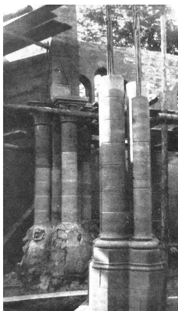
102 Sainte-Jeanne-d'Arc, Saint-Denis. Colonnes avec leurs armatures. Le Christ dans la banlieue , N° 3, 1932.
