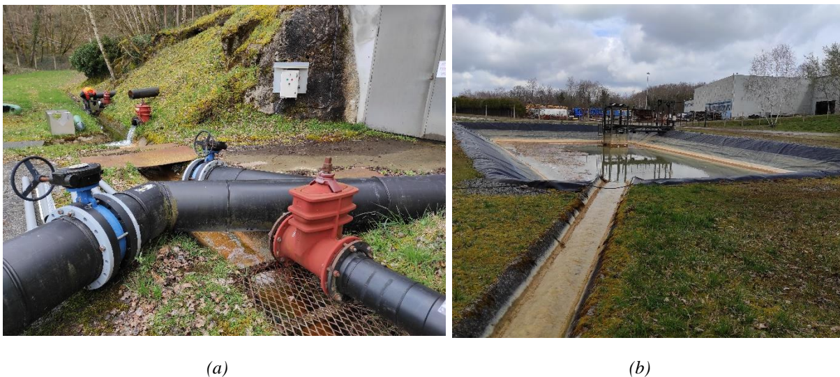
Figure 4.3 : (a) Arrivée des drains à la station de traitement (avant l'installation des déversoirs) et (b) le bassin de réception et la pompe acheminant l'eau vers la station de traitement.
