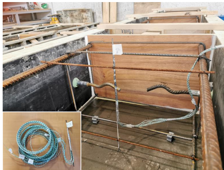
Figure 79 : Echelle de thermocouples
