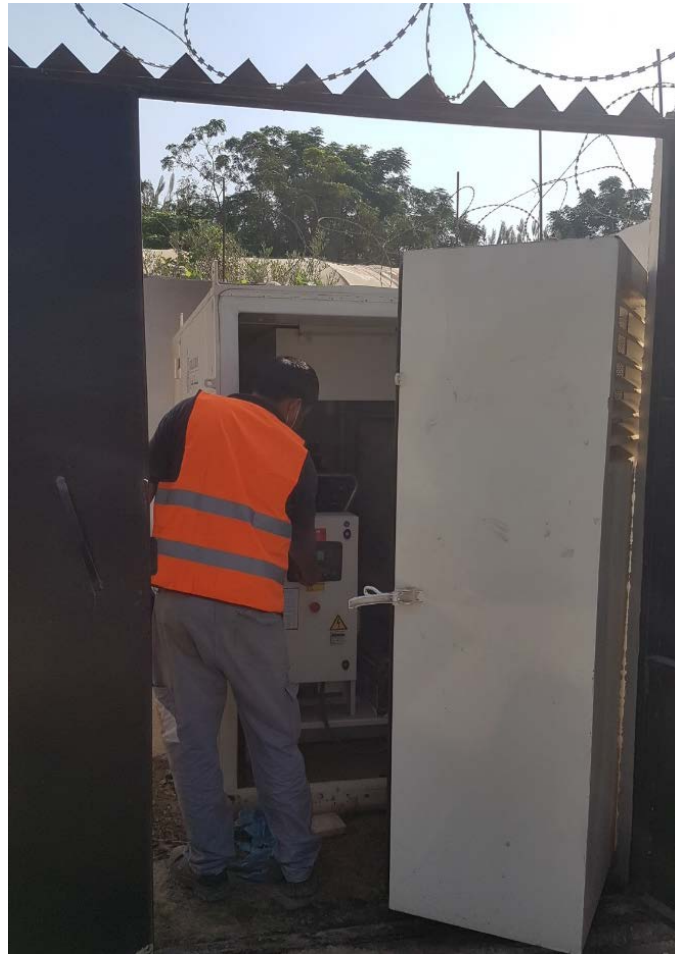
Fig. 29 - La station du puits Haj-Obeid à Mhamra (Ahmad KAMALEDDINE, 14/09/2020)
