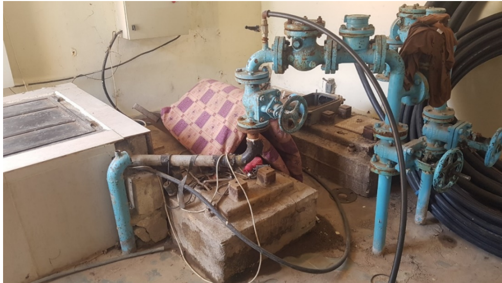
Fig. 27 - La station du puits Mbarkine à Bzal (Ahmad KAMALEDDINE, 24/09/2020)
