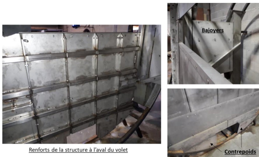
Figure 6-21. Vues sur les renforts à l'aval du volet, les bajoyers et les contrepoids
