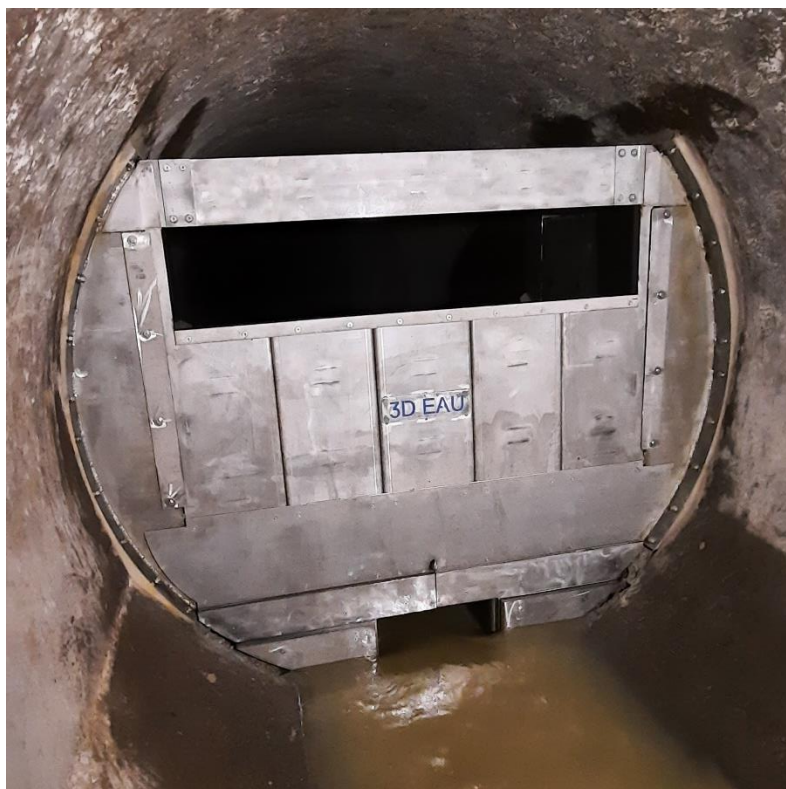
Figure 6-25. Vanne mise en fonctionnement dans le réseau
