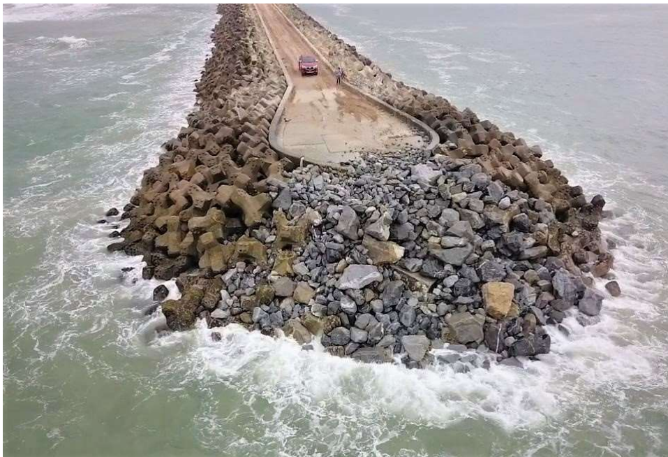
Photo 11. Désordres de la protection du musoir de l'épi « Arrêt de sable », port de Cotonou, Bénin (Photo : CDR International B.V.)
