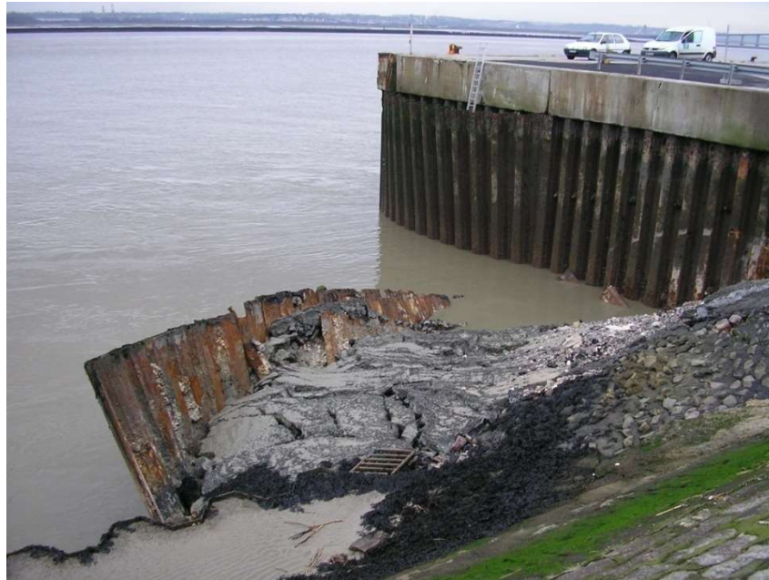
Photo 4. Etat-limite ultime d'un soutènement de berge en Seine à Honfleur, Calvados (Photo : Haropa)
