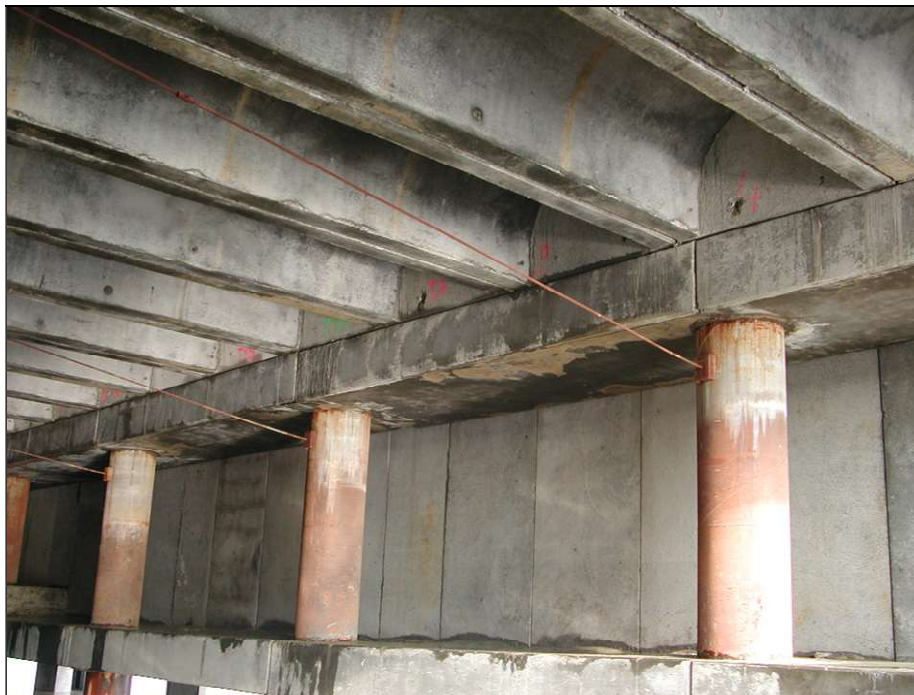
Photo 14. Pieux supportant la dalle du 3 e Quai en Seine du port d'Honfleur (Haropa), Calvados (Photo : EMCC)
