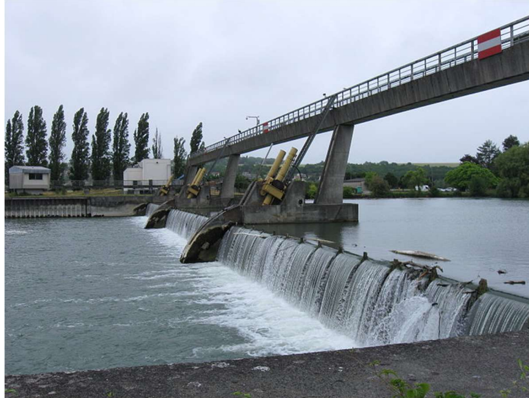
Photo 13. Barrage mobile à clapets de Varennes-sur-Seine, Seine-et-Marne (Photo : thor19, sous licence Creative Commons)
