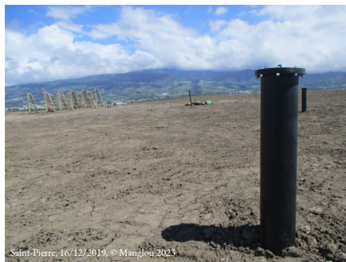
Une couche fermée recouverte de géotextile puis de terre, avant la végétalisation. En premier plan, un tuyau d'évacuation du gaz.
