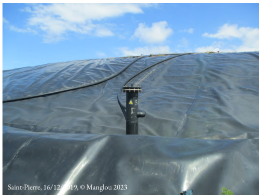
Bâche de recouvrement d'une tranche fermée, avec un tuyau d'évacuation du gaz.
