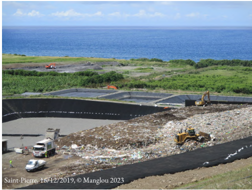
Tranche active. Des bulldozers travaillent à aplatir les couches de déchets dans une cuvette recouverte de géotextile. En arrière plan, des bassins de dépollution des eaux.
