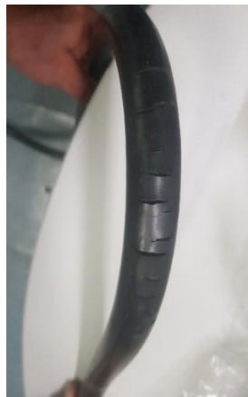
Figure 2. Photographie d'un tuyaux usés qui présente des craquelures visibles
