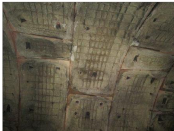
c) Dégâts à la voûte du tunnel au droit des camions incendiés, tunnel sous la Manche, Sur une soixantaine de mètres, l'enrobage s'est détaché laissant voir les armatures des voussoirs, BEATT/RAIB 2015,
