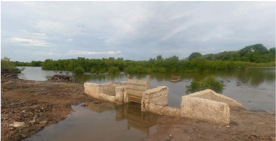
Figure 68. A Edioungou, au lieu-dit Louem. La digue bétonnée construite dans le cadre d'un projet de développement international en 2006, n'a pas survécu aux assauts répétés des marées et n'est plus à ce jour d'aucune utilité, 2022.
