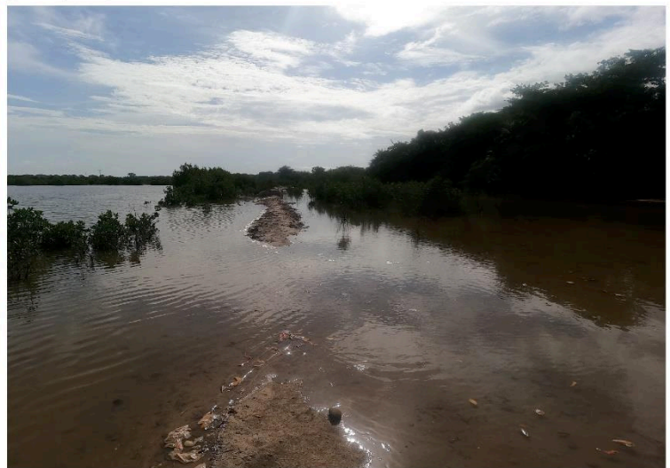
c. les digues abîmées ne permettent plus de barrer le bolong, qui crée ainsi des zones intertidales riches en vases (Etama, 2021)
