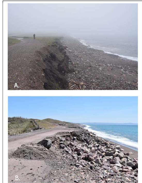
Photo 13 : Les impacts de l'érosion.
