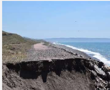
Deux brèches sur la route de l'isthme du fait de l'érosion hivernale en 2021, coupant l'axe de communication. Photo de gauche : les enrochements posés en appoint ont été démantelés par la mer et utilisés comme projectiles, aggravant l'érosion. Photos : X. Philippenko, été 2021.
