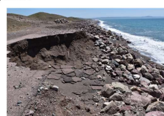
Blocs d'enrochements posés pour protéger la route de l'isthme : suite à des tempêtes, l'effet est inverse et accroît l'érosion
