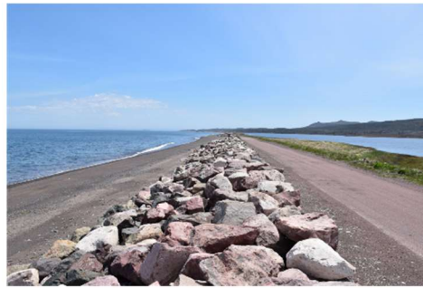
Protection du littoral par enrochement sur la route de Mirande. Source : Xénia Philippenko, 2021
