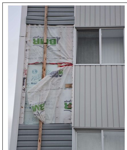
Photo 34 : Dégâts sur la façade d'un immeuble à Saint-Pierre après la tempête du 28 novembre 2018. Photographie : X. Philippenko, 2018.
