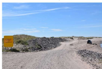
Route de l'isthme entre Langlade et Miquelon, menacée par la submersion et l'érosion
