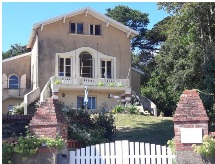
Fig. 22 : Chalet Arnaud, construit en 1856 près de la plage de la Noëveillard. La situation de ce chalet est remarquable, en surplomb de la baie, mais l'enduit est devenu peu flatteur. Le chalet semble souffrir de l'humidité. Photo personnelle, 2022.
