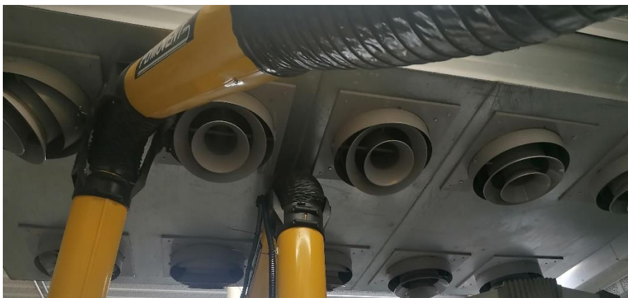
Figure 37. Photo de l'arrivée de la ventilation par le plafond de la cellule d'essais.
