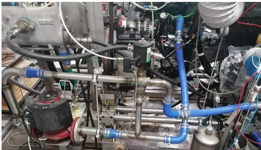
Figure 75. Photo du circuit de refroidissement utilisé pour la macération du moteur
