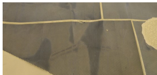
Figure 79 : Décollement du papier sous la contrainte impliquée par la rétraction du zip, FLC31064.
