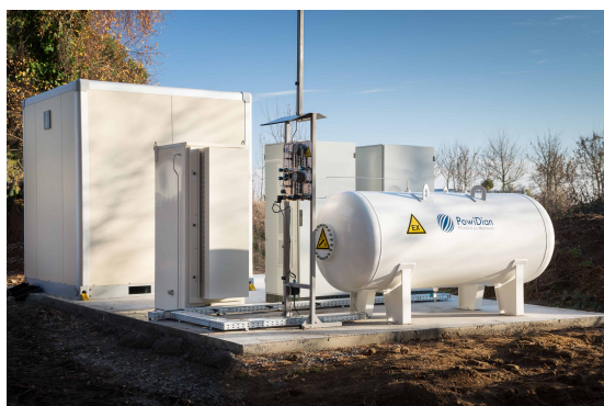
(a) Stockage hydrogène 5 kg à 30 bars
