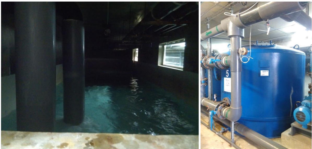
Figure 24 : Un bac tampon et un filtre à sable du grand bassin de la piscine de Vue Belle
