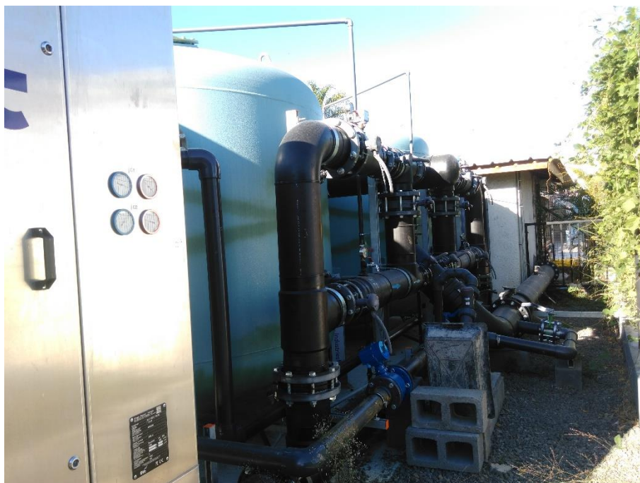
Figure 29 : Pompe à chaleur et filtres à sable de la piscine du bois de nèfles à Saint Paul
