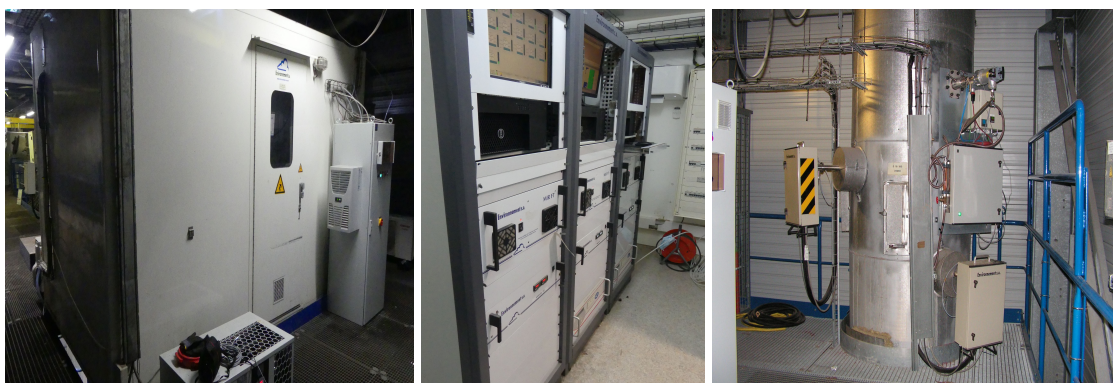
FIGURE 1.15 – Local (à gauche) dédié aux AMS (au milieu) à proximité de la cheminée du CVE (à droite) équipées de points de prélèvements et d'échantillonnages des fumées.
