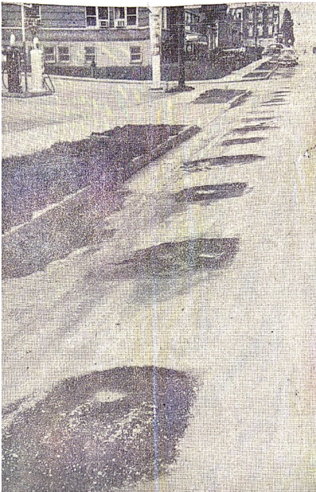
Figure 133 : Trous dans le pavage de la rue Hochelaga à cause des travaux effectués par la Corporation de gaz naturel du Québec
