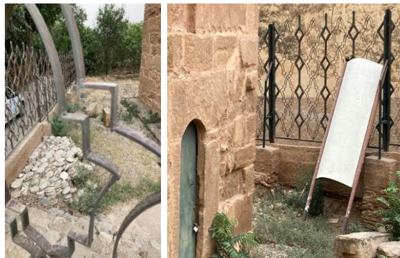
Figure 59 État dégradé de l'espace entourant le minaret d'Agadir. Photos Imad Errouane 2022
