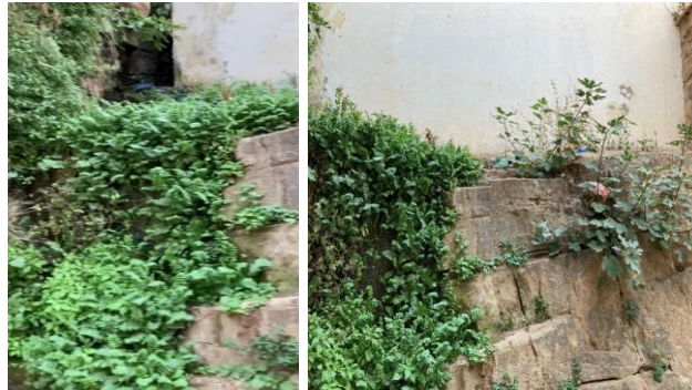
Figure 56 Fuites de canalisations au complexe Sidi Boumediene. Photos Imad Errouane 2022
