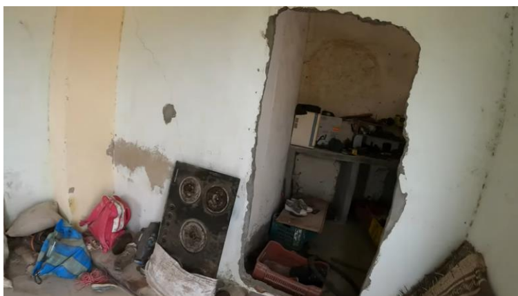
Figure 128. Un mur détruit pour permettre l'extension de l'espace de vie. (Source : Scafidi, 2018)
