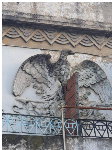
Figure 24 Façade détériorée à Bizerte. (Winou le Patrimoine, 2023)
