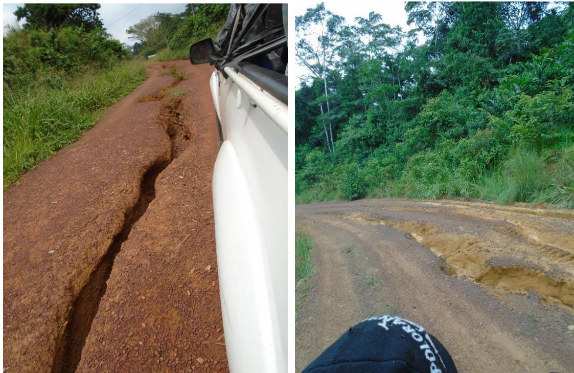
Route en latérite dégradée entre Makokou et Okondja dans le sud-est du Gabon (2 e province visitée). Route très peu desservie durant toute l'année, même en saison sèche, période au cours de laquelle il pleut très peu. La présence du chemin de fer dans cette partie du pays, n'encourage pas l'État à faire plus d'efforts.
