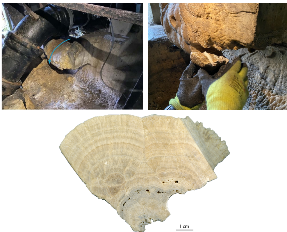
Figure 2-17. En haut, localisation de l'échantillon et de la coulée dans la cunette du regard 13 de l'aqueduc des Eaux de Rungis. L'écoulement de l'eau dans la cunette est illustré par la flèche bleue. En bas, échantillon RUN-C-04 vu en coupe transversale
