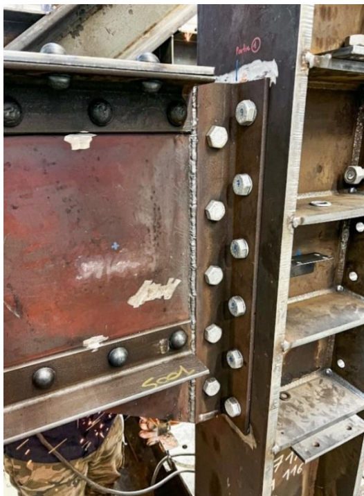
a). Côté gauche de l'assemblage
