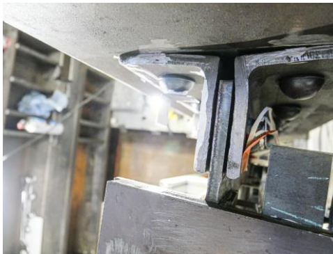
e). Déformation des cornières d'AR-1
