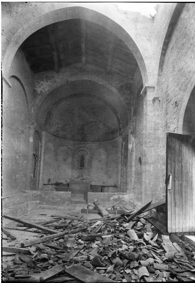
Figure 26. Saint-Sylvestre-des-Brousses ou de Montcalmès (Puéchabon). Gravats provenant de la charpente et de la couverture, intérieur de la nef, vus depuis l'ouest (1916, photo : Henri Nodet).
