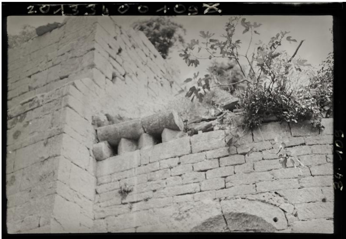
Figure 27. Détail du chevet, vu depuis le sud (fin XX e siècle). Vestiges de la frise à dents d'engrenage avant restauration.
