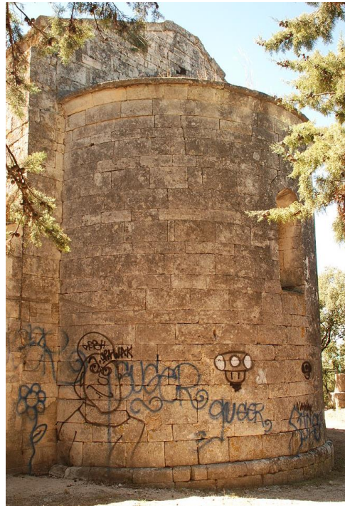
Figure 50. Chevet, vu du sud, après dégradations (2011, photo : EmDee).
