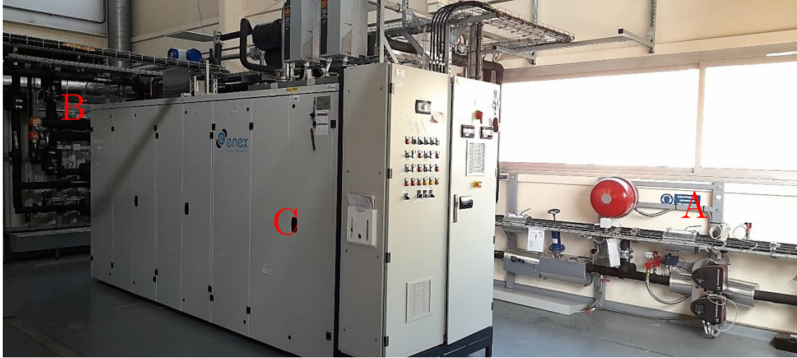
Figure 2.1. Banc d'essais avec les trois circuits : le circuit de réjection de chaleur (A), le circuit de simulation du besoin de froid (B) et le groupe de production de froid au CO 2 (C).
