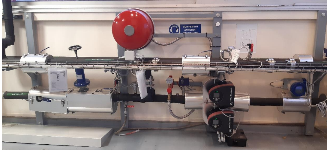
Figure 2.2. Photo du circuit d'eau de réjection de chaleur (A).
