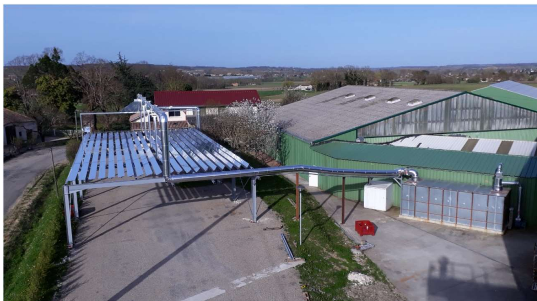
Figure I.28 : Centrale solaire de production de chaleur industrielle conçue par IDHELIO
