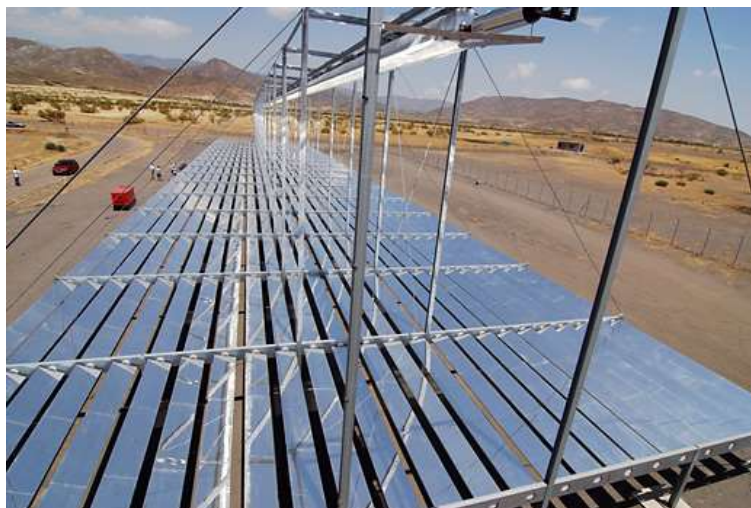
Figure I.22 : Prototype d'un concentrateur linéaire Fresnel, nommé FRESDEMO, installé à Plataforma Solar de Almería en Espagne [141]
