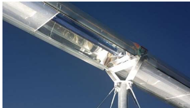
Figure III.5 : Photo d'une vitre manquante au niveau du récepteur
