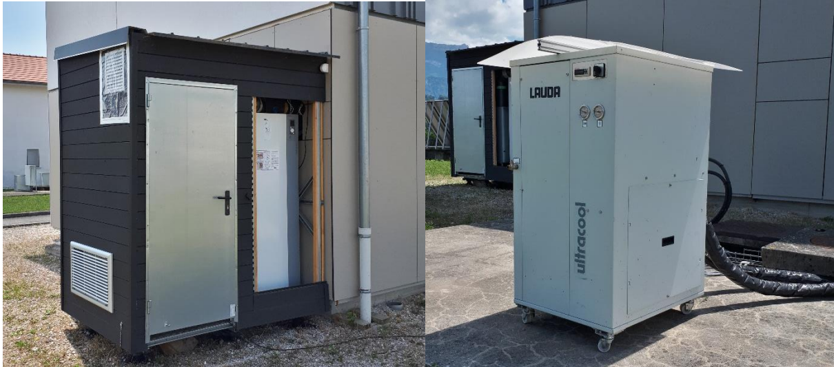
Figure 5-18 - A droite le refroidisseur, à gauche le module des systèmes adjacent à la maison I-BB
