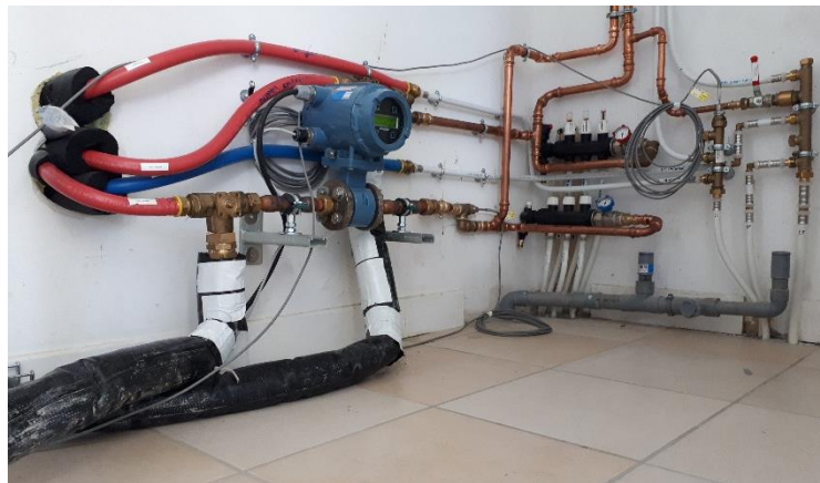
Figure 5-19 - Raccordement du refroidisseur au réseau hydraulique dans le vide sanitaire de la maison
