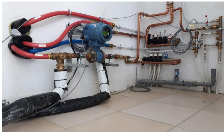
Figure 5-19 - Raccordement du refroidisseur au réseau hydraulique dans le vide sanitaire de la maison
