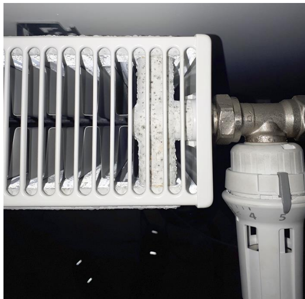
Figure 5-20 - Condensation au raccord entre le plus grand convecteur du salon et le réseau le 25/07/2022 où l'humidité relative avait temporairement augmenté jusqu'à 65%
