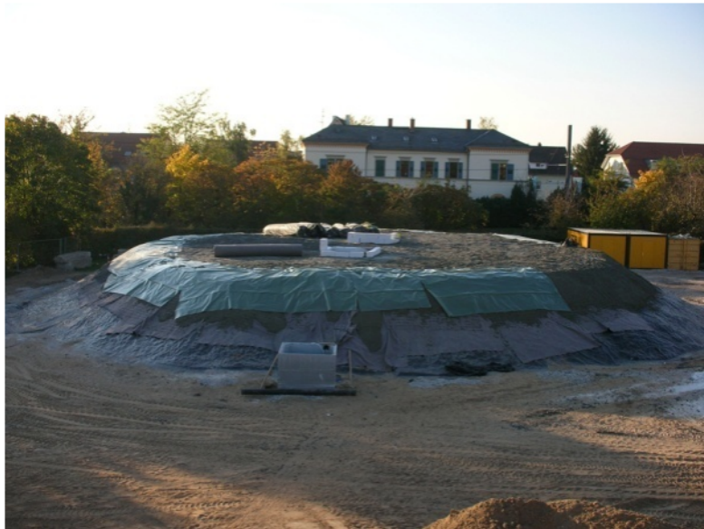
FIGURE 1.30 – Le toit du PTES de Eggenstein-Leopoldshafen[40].
