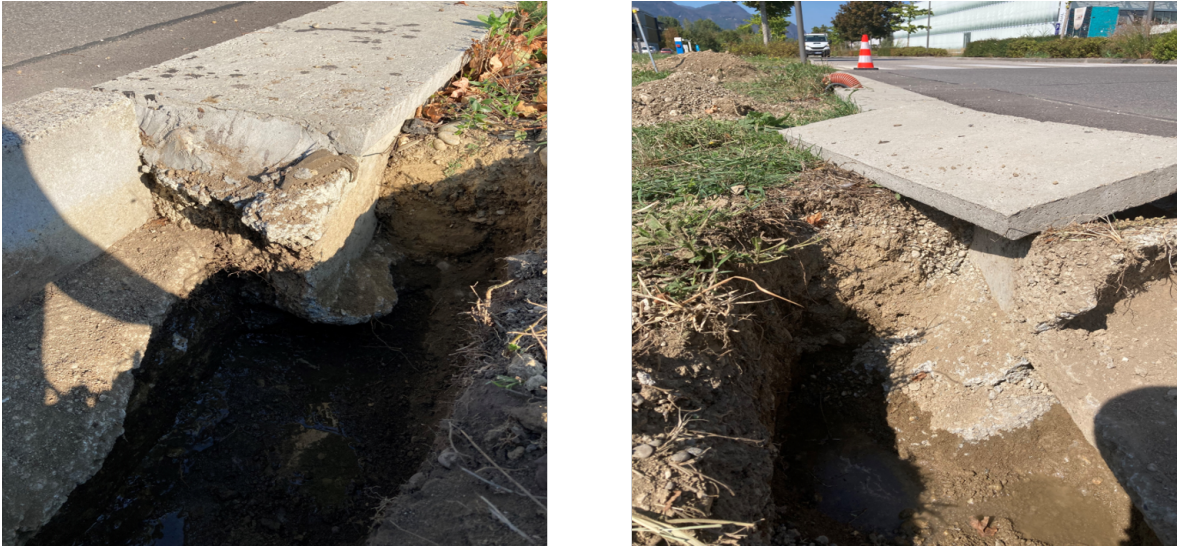
FIGURE 2.27 – Fuites d’eau dans les caniveaux amont (à gauche) et aval (à droite)
