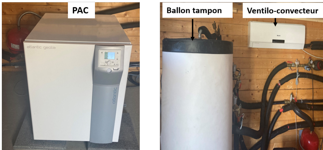
FIGURE 2.17 – La pompe à chaleur , ballon tampon et le ventilo-convecteur
