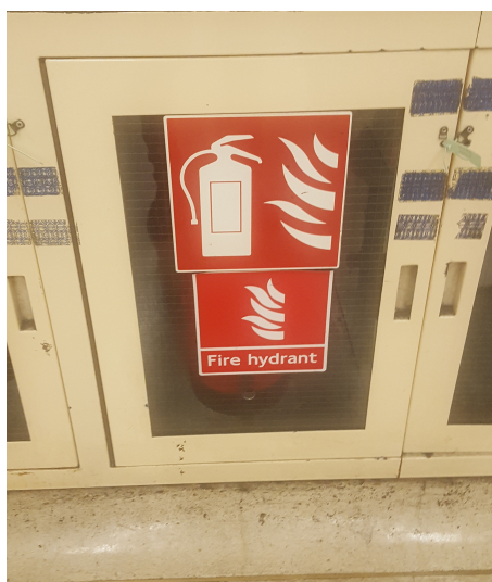
(a) Extincteur caché.
