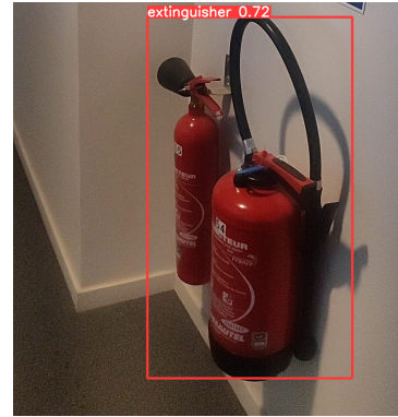
(b) Détection superposée pour 2 extincteurs dans une même boîte.
