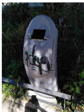
Figure 24 - Photo prise durant l'arrêt n°2 (borne d'alimentation en eau potable)
