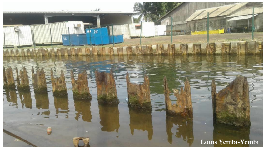
Figure 6-26 : Etat des Palplanches des canaux de la ville comme facteur d'aggravation des inondations dans le centre-ville (photo prise le 5 décembre 2021 à 14h48, Niveau de la marée prédite 1,3 m (NGCLZ) marée montante avec un niveau absolu prédit à 1,79 m (NGCLZ).
