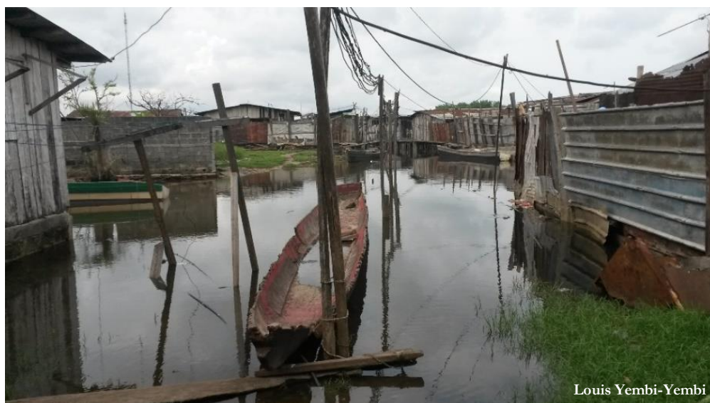
Figure 2-30 : Inondation par la mer et installation précaire des câbles électriques (Photo prise le 12/01/2017 à 16h, marée prédite 2,2m en ZH)
