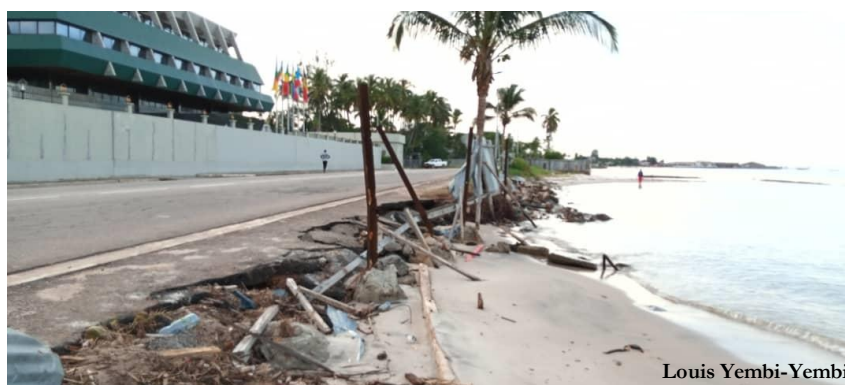
Figure 6-24 : Vue de la principale route du front de mer de la côte est au niveau de la BEAC en dégradation en raison des travaux de la digue inachevés
