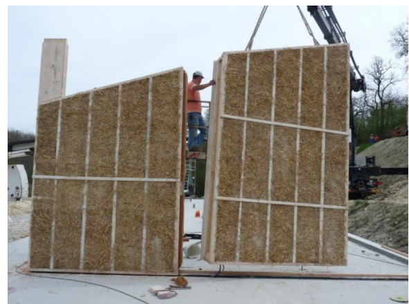
(b) Caissons porteurs remplis en paille La paille est utilisée en remplissage comme isolant de caissons qui assurent la fonction porteuse de l'ouvrage.
