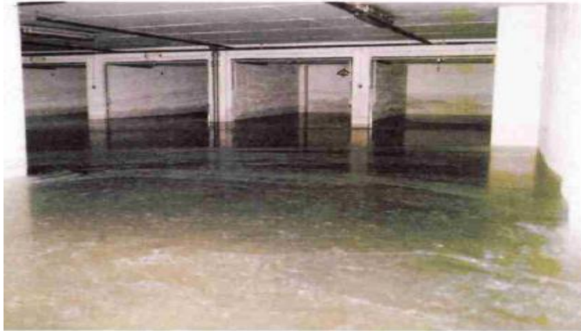
Figure 2. Parking souterrain inondé par remontée de la nappe. Paris en 1975.
