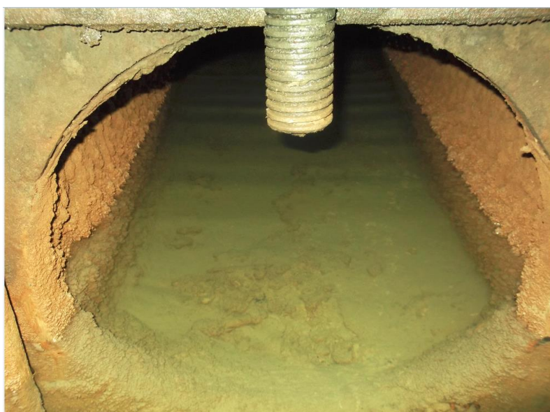
Figure III.B.4. Accumulation des eaux d'exhaure au PEP d'Hôtel de ville. Septembre 2013
