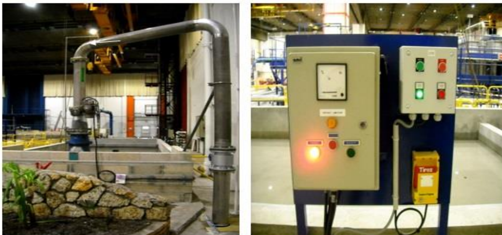
Figure 14. Photo de l'alimentation (à gauche) et l'automate (à droite).
