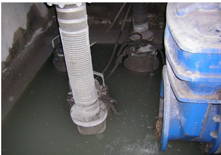
Figure III.B.3. Accumulation des eaux d'exhaure au PEP de Louvre. Avril 2013
