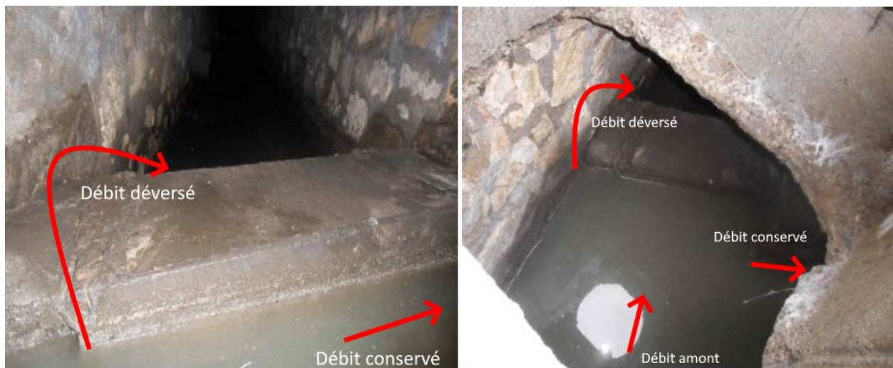
Figure 3.19 : Déversoir d'orage « Place de l'Estang »
